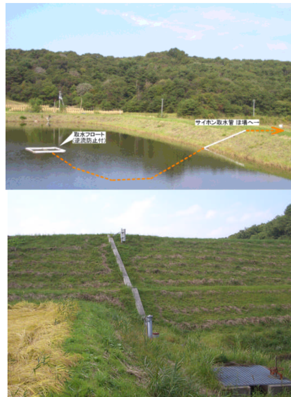
写真4 宮城県 Y 地区のサイホン式取水装置設置事例
