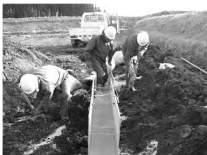
写真2 掘削断面の崩壊により型枠で作業
