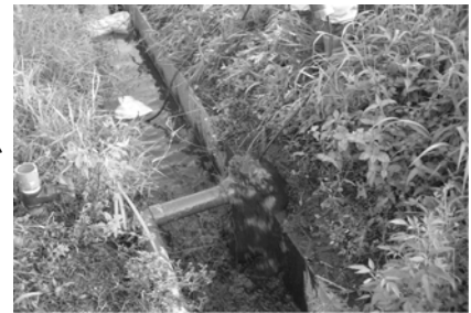
写真1 用水路に堆積した泥及び暗渠管洗浄時の状況
